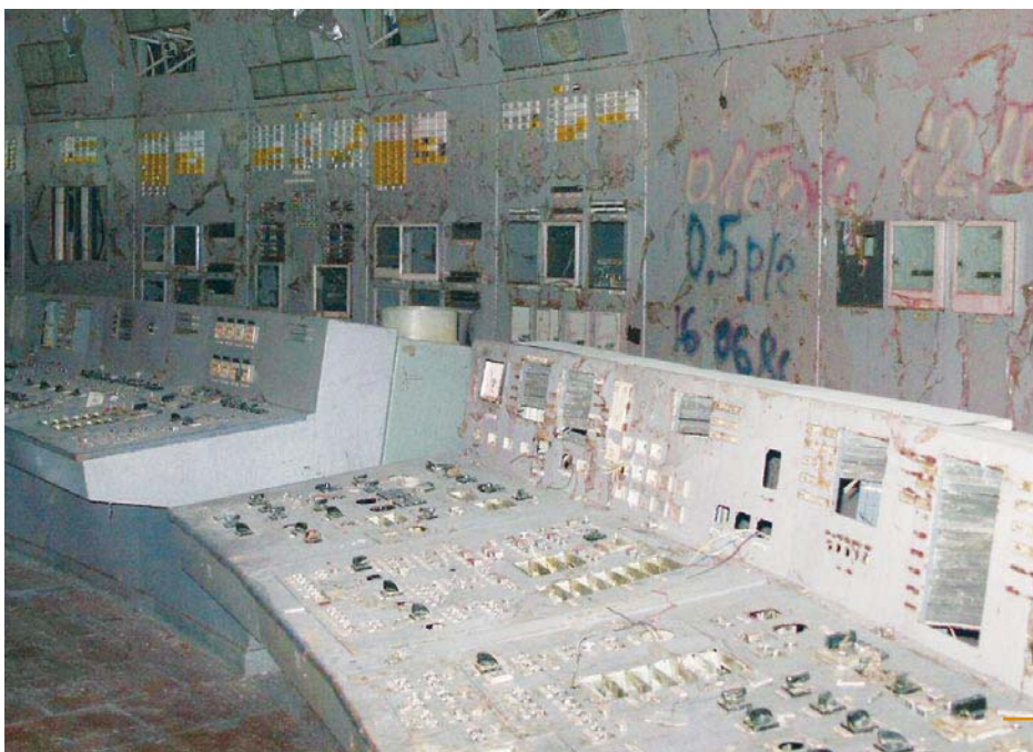
Blick in die zerstörte Warte des Blocks 4
